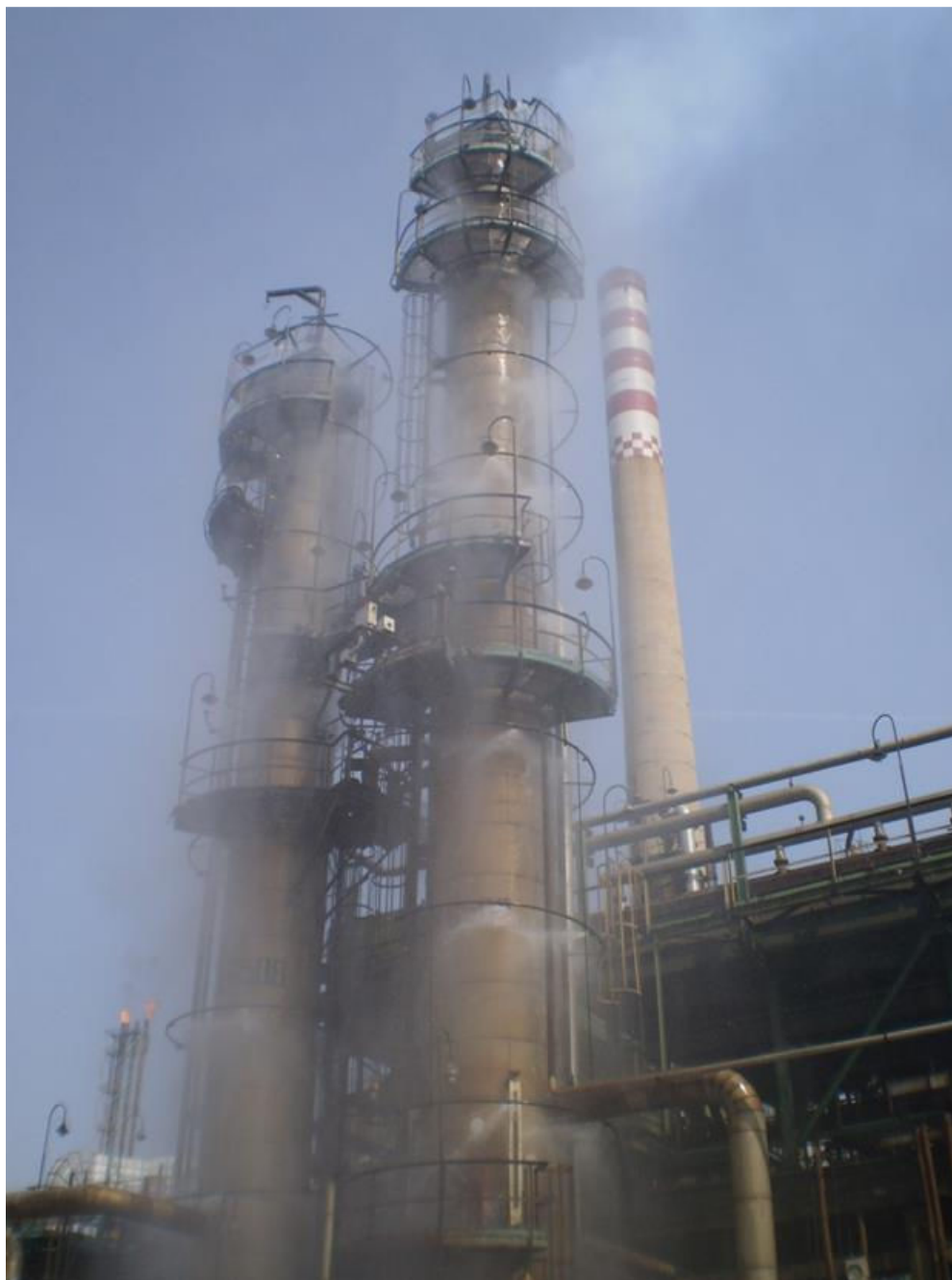
Slika 72. Stabilni sustav za hlađenje raspršenom vodom, sustav zaštite od požara
